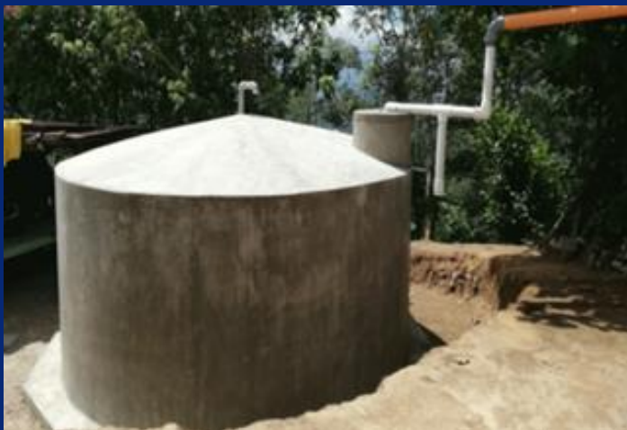
Figura 6. Cisterna de ferrocemento para captación de agua de lluvia
